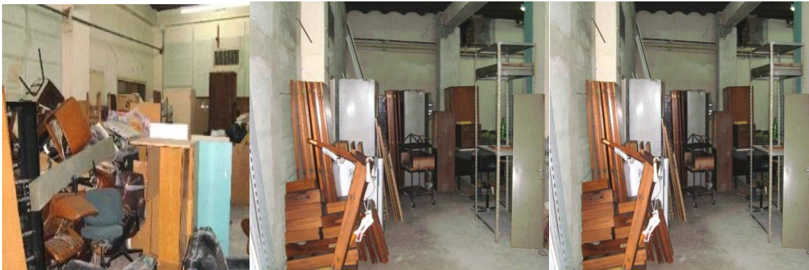
Estado de abandono y material que se encontraba en la Sala principal del Archivo
